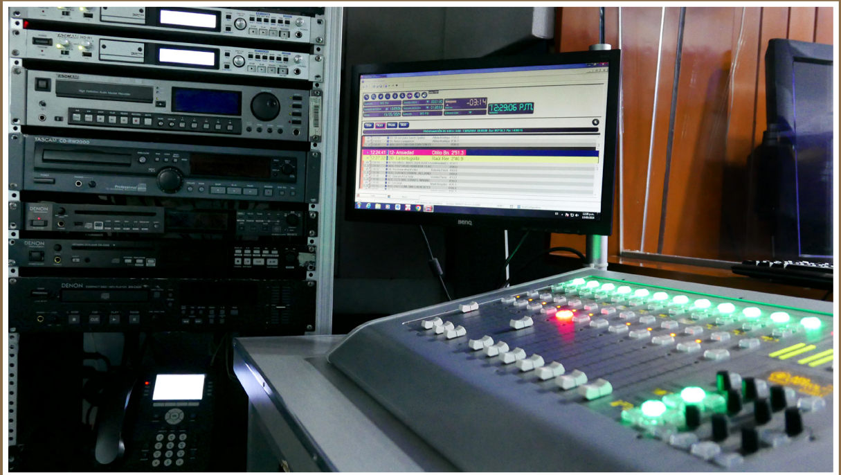
Fig. 99. Software y controladores de hardware de última generación: inversión necesaria en una estación para mantenerse al día en la generación y producción de contenidos. Instalaciones, 2024. Fotografía de Álvaro Rodríguez.
